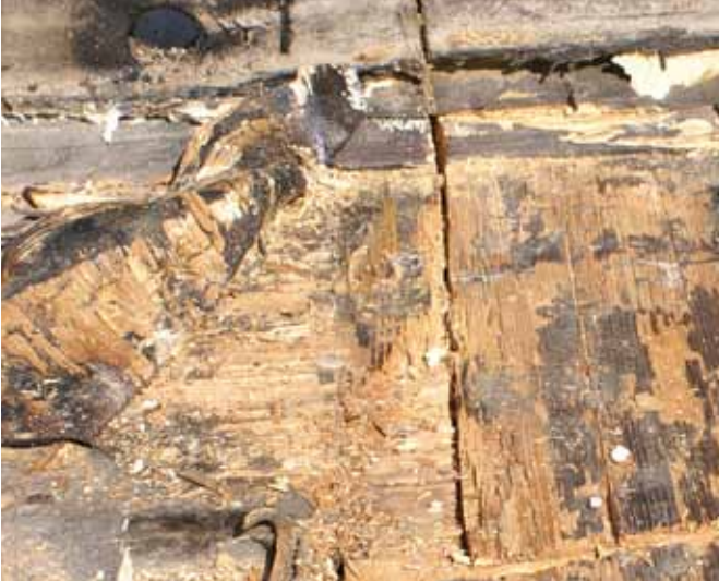
Abb. 3: Schadensbild Sekundärkondensat durch Restfeuchtverlagerung
