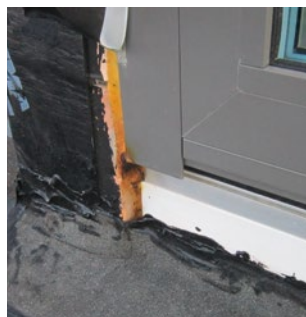
Bild 3 Der Anschluss kann nicht dicht ausgeführt werden
