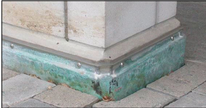
Abb. 3: Verfärbung von Kupfer verzinkt. Diese Art von Verfärbung tritt unter Einwirkung von Streusalz in Erscheinung.
