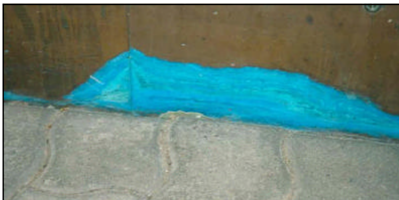
Abb. 1: Zementgebundene Verbundsteine, die ohne Schattenfuge an das Winkelblech angeschlossen werden, führen zu Verfärbungen, die nur mechanisch zu entfernen sind.
