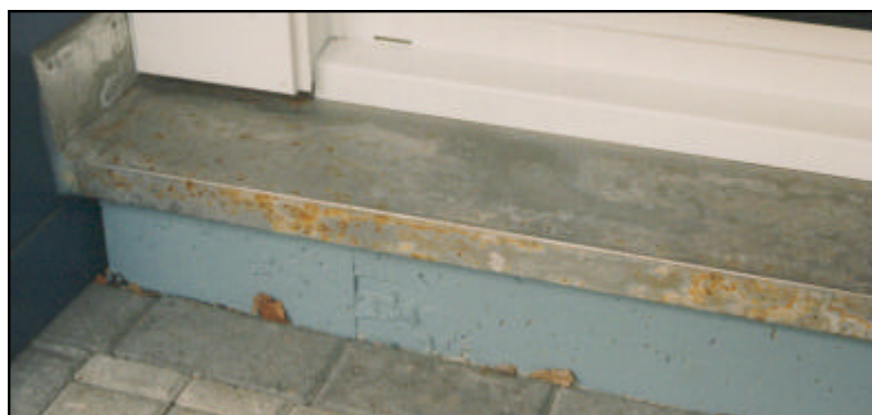
Abb. 4: Verfärbung von verzinntem Chromstahl durch chloridhaltige Fensterputzmittel.
