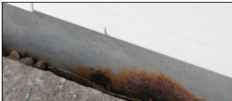
Abb. 2: Verfärbung von verzinntem Chromstahl im Flachdachbereich. Um die Zinnschicht nicht zu verletzen, ist auf eine mechanische Reinigung zu verzichten.
